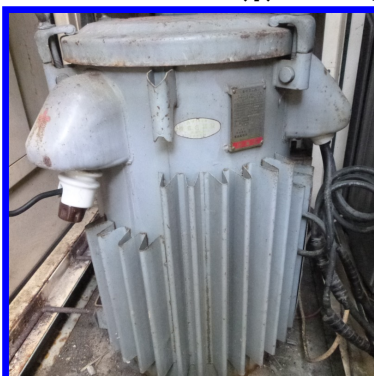
トランス（変圧器）
